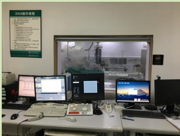
图6-1 机房操作位、观察窗、操作规程上墙
